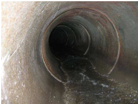
I de tett bebygde områdene i Kristiansund håndteres overvannet ved hjelp av ledningsnett. Bildet er fra overvannsledningen under Løkkemyrveien Syd.
