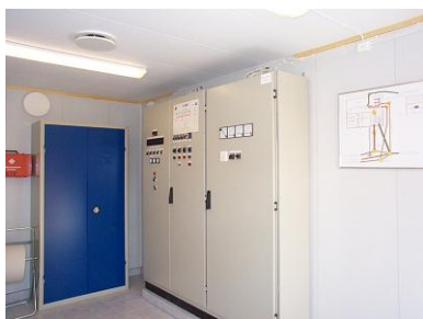
Elektroskap i de nye anlegg.
