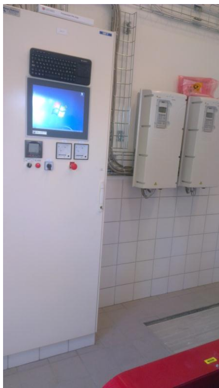
Elektroskap i nye anlegg
