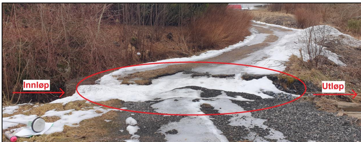
Figur 24 viser erosjonsskader på grusvegen hvor bekken krysser under via tre stikkrenner. (Foto: Kristiansund kommune)
