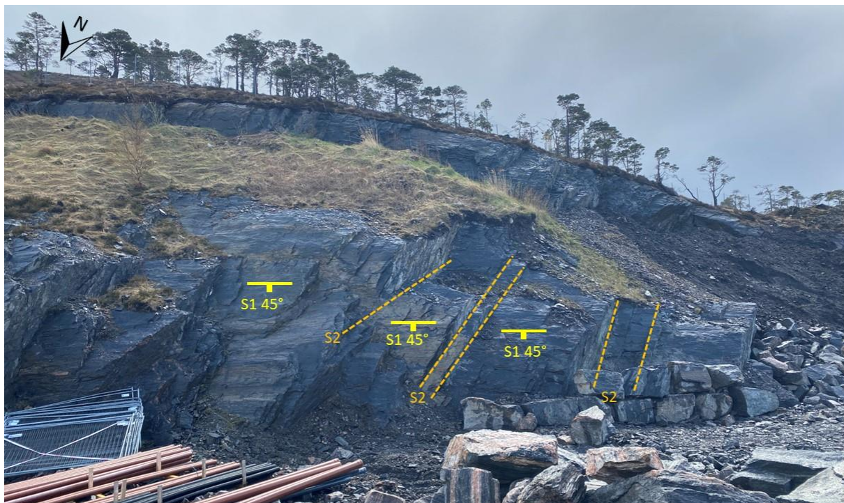
Figur 5: Bergskjæring sørøst. Vestre del av bergskjæringen. Gjennomsettende oppsprekking er markert i foto.
