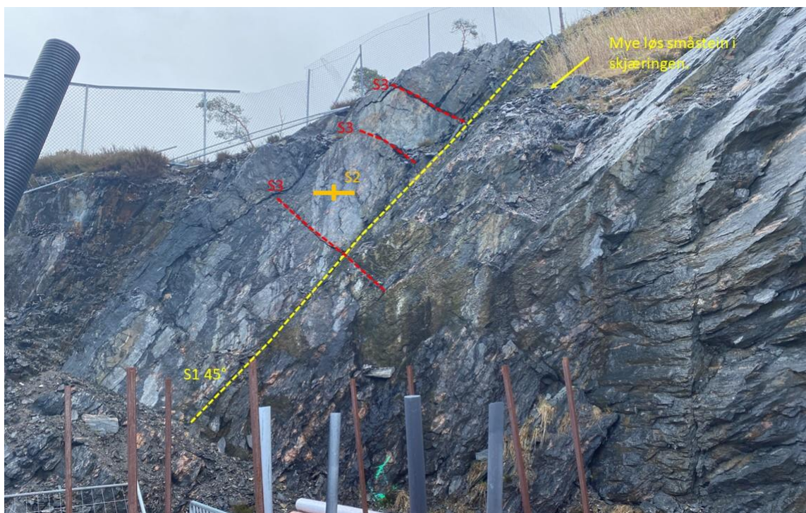
Figur 3: Bergskjæring nordøst. Foto av hjørnet mellom bergskjæring nordøst og sørøst. Dominerende oppsprekking er markert i foto.
