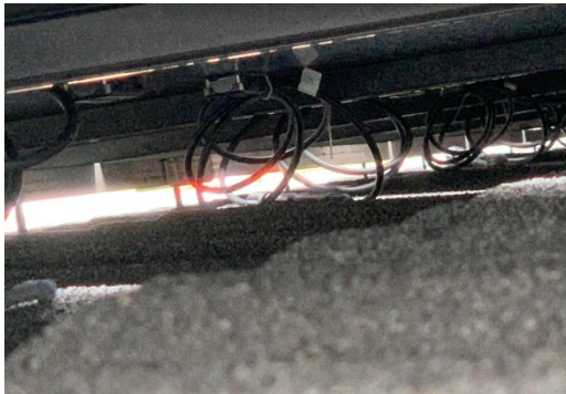
Kabler og koblinger skal ikke ligge/hvile på taket under panelene.
