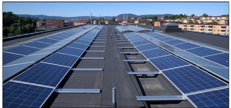
Sett av plass mellom panelene for ferdsel til vedlikehold og eventuell slukking.
