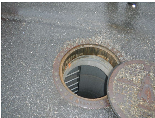
Her er stigen plassert på veggen i kummen, noe som gjør det vanskelig å komme til på en trygg måte.
